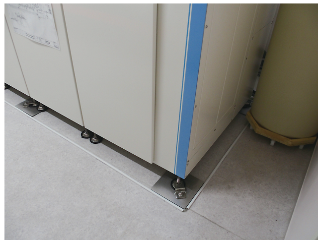
図3 透析液供給装置、RO装置の固定 （著者作成）
