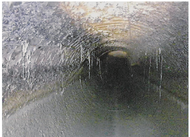
図3 硫化水素による下水管の腐食
