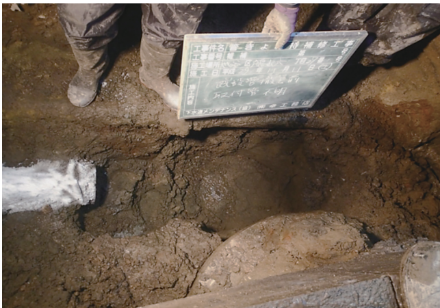
図1 下水道管の消失
