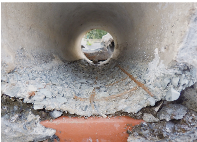
図2 コンクリートの損傷
