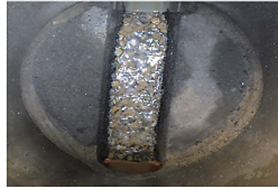
損傷ケース1:汚水ます
