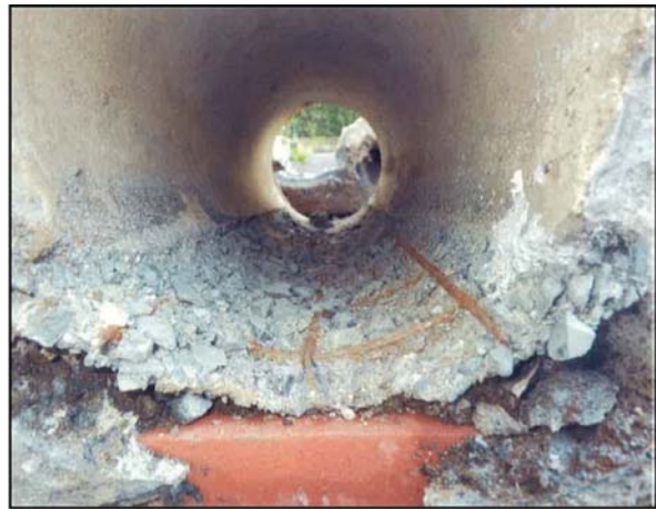
損傷した下水道管
